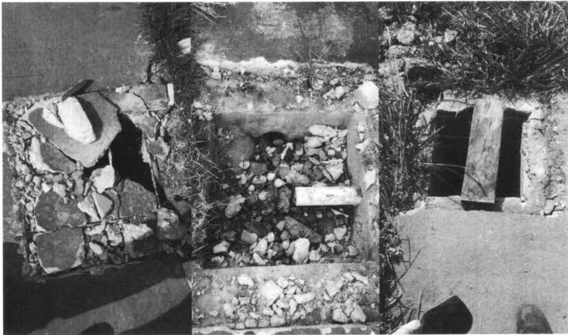
Figura 6 – Caixas de inspeção danificadas, antes da substituição.
