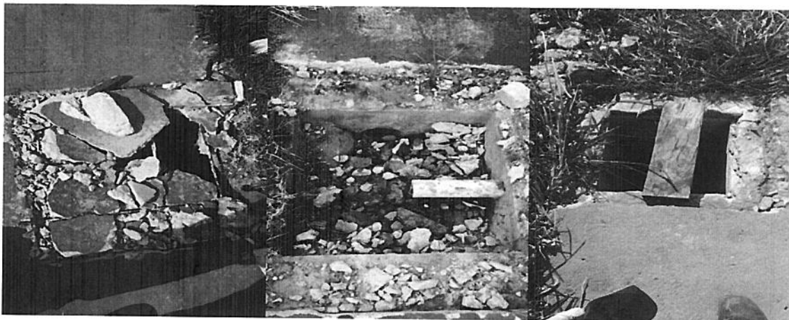
*Figura 6 – Caixas de inspeção danificadas, antes da substituição.
