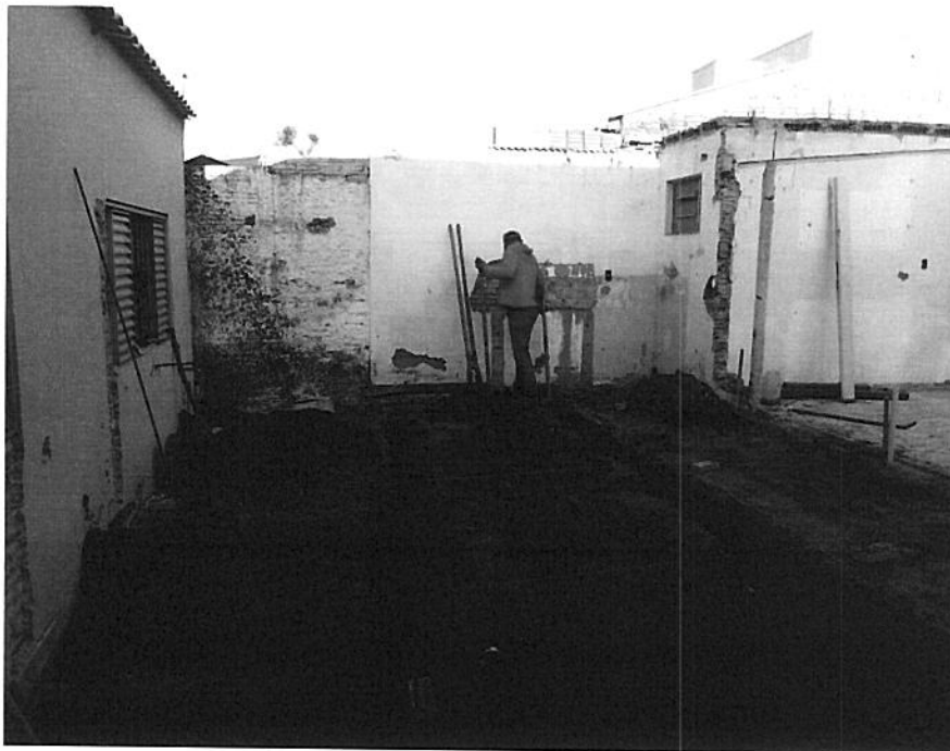
Fig.7 – Local onde será construído: (sala de curativo, lavanderia, copa e banheiro de funcionários).
